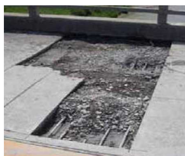
凍害による 床版上面の損傷
