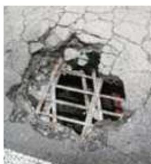
床版の疲労による 部分抜け落ち
